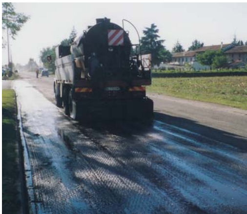
Fig. 8 - stesa di una mano di attacco a mezzo di autocisterna dotata di tubo portaugelli di spruzzatura
